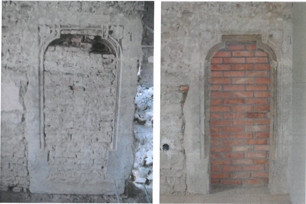
Fig. 70 Ancadrament de ușă gotică din camera E8.1 în timpul lucrărilor de renovare (2009-2010)
